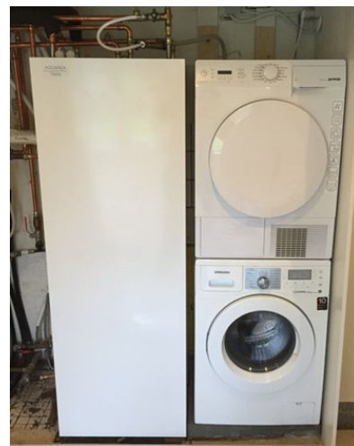
Varmepumpe indedel med 300 L buffertank. Lige så stor som en vaskesøjle
